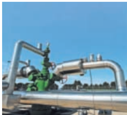
Dieser Kopf bildet den obertägigen Abschluss einer Kaverne.
